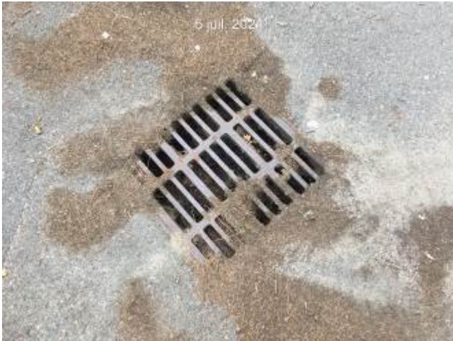
Regard EP obstrué
