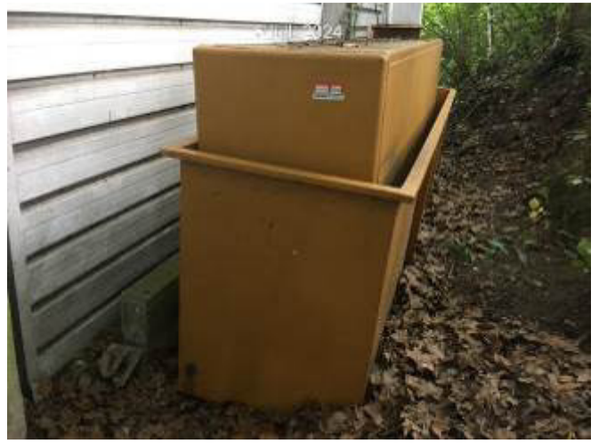
Dépotage cuve non aménagé
