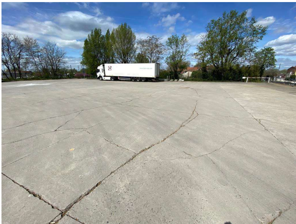
Figure 31 : Fissuration du dallage, éclats de béton.
