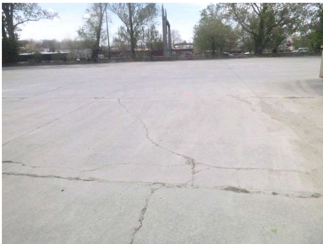
Figure 28 : Fissuration du dallage, éclats de béton.
