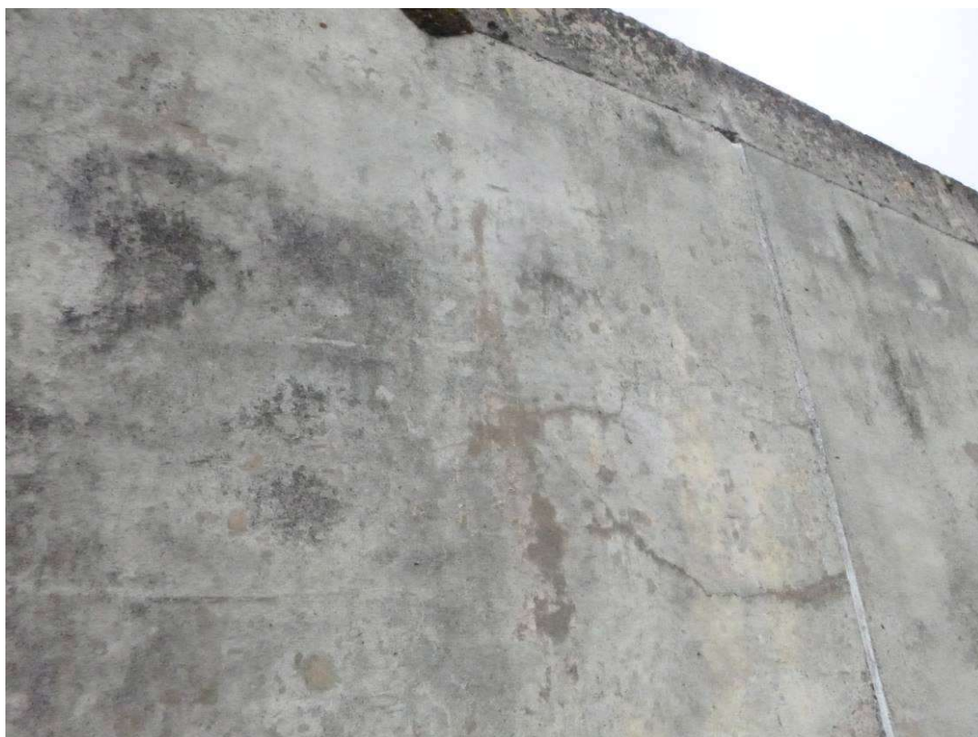
Figure 45 : Microfissure, traces d'humidité.
