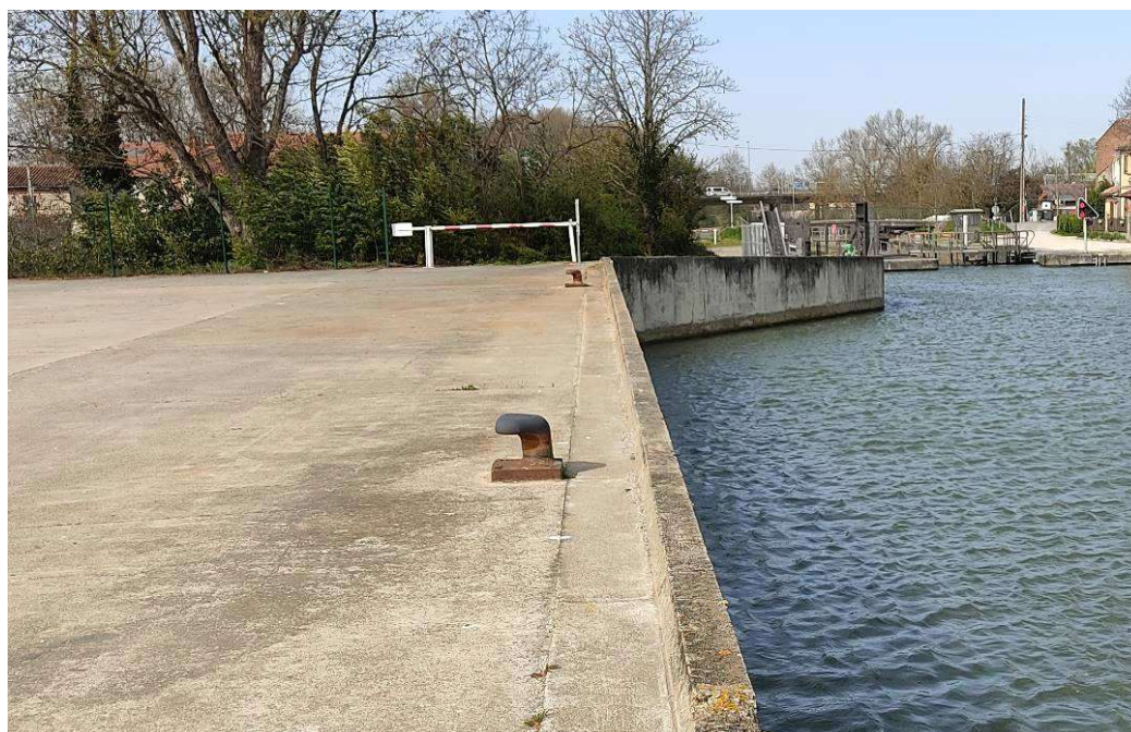
Figure 34 : Bitte d'amarrage présentant quelques traces de corrosion.
