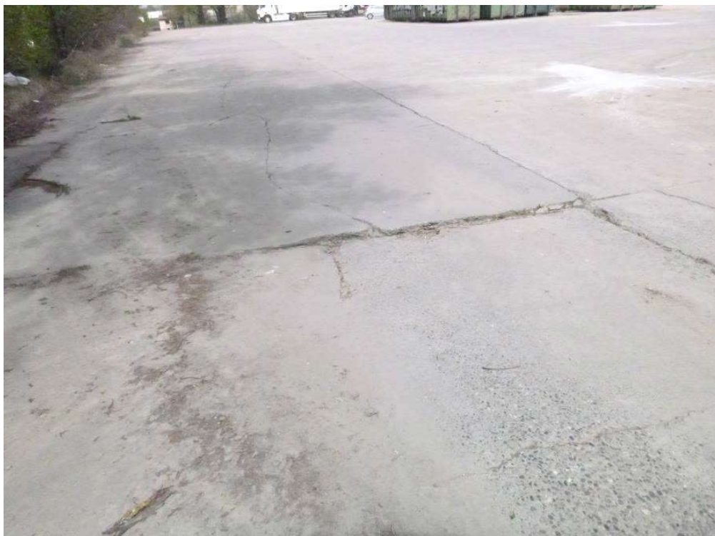
Figure 1 : Fissuration du dallage, éclats de béton.
