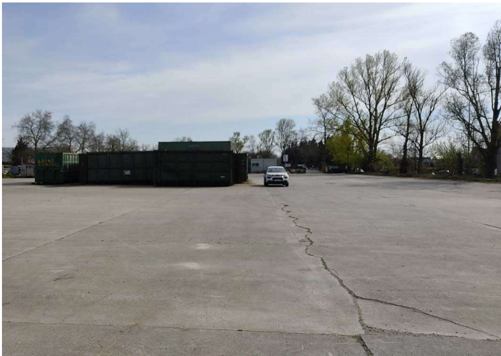
Figure 15 : Fissuration du dallage, éclats de béton.
