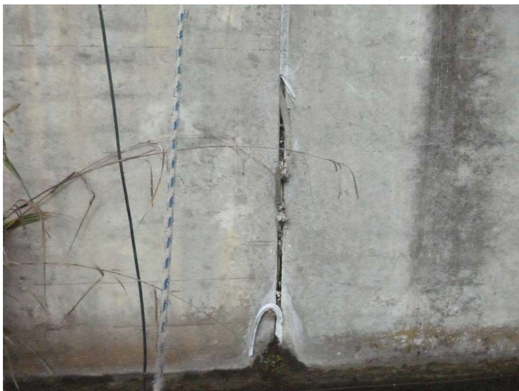
Figure 48 : Usure avancée du joint entre panneaux.
